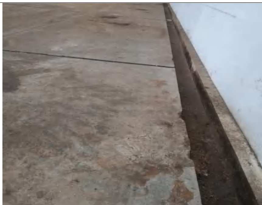
图4.4-3 危废存储区域现状图
