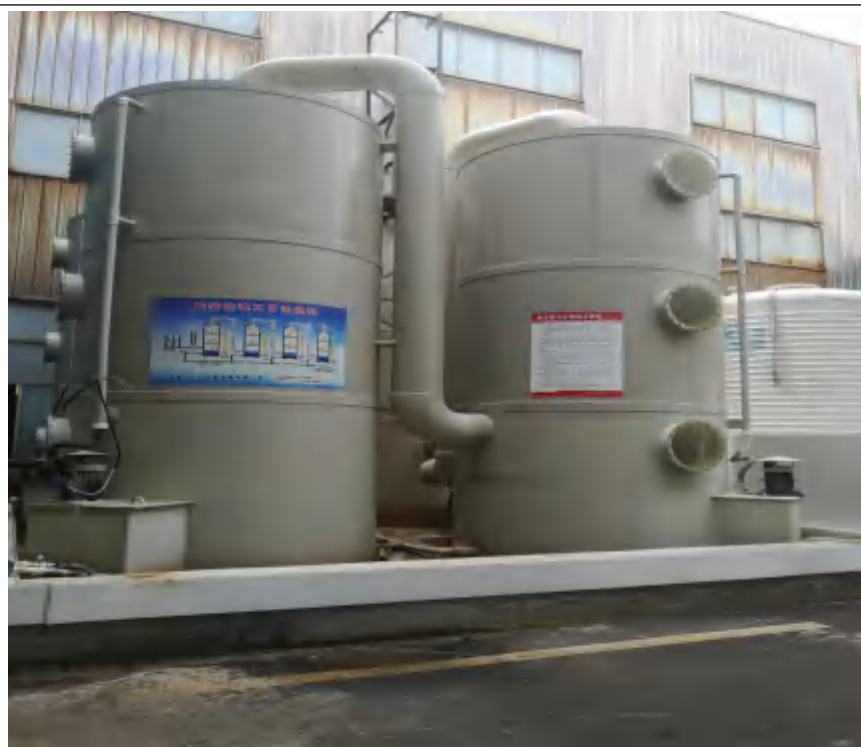
图4.4-2 废气处理区域现状图
